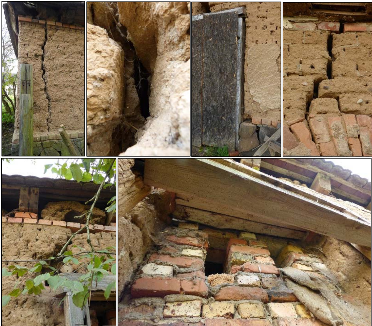
Abb. 18: exemplarische Bilder von Rissen, Nischen, Hohlräumen und Öffnungen in der Fassade des Seitengebäudes
