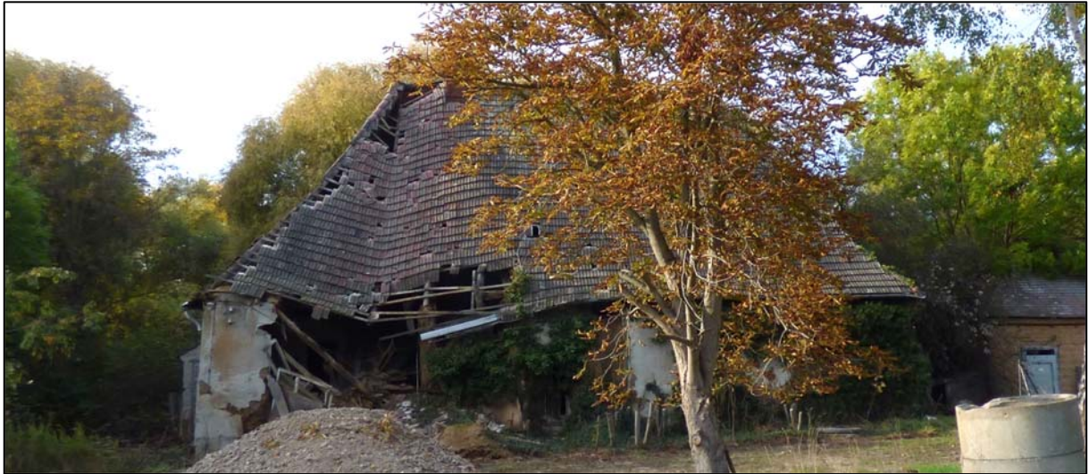
Abb. 2: Außenansicht der Südostseite des abzureißenden Wohnhauses mit eingestürztem Bereich
