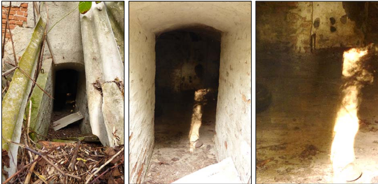
Abb. 10: Kellerraum unterhalb des südwestlichen (eingestürzten) Bereiches des Wohnhauses
