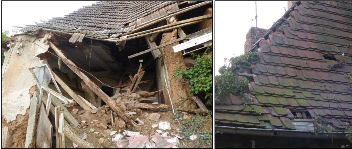
Abb. 6: eingestürzter Bereich des westlichen Teils der südöstlichen Fassadenseite; fehlende Dachziegel
